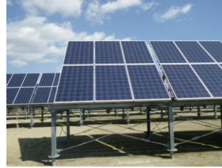
太陽光パネル
