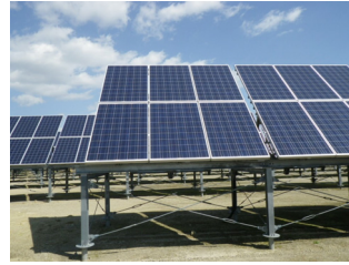
太陽光パネル
