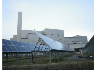
太陽光パネル
