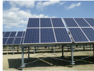
太陽光パネル
