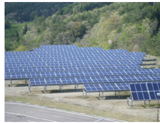
太陽光パネル
