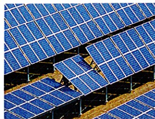
太陽光パネル角度調整
