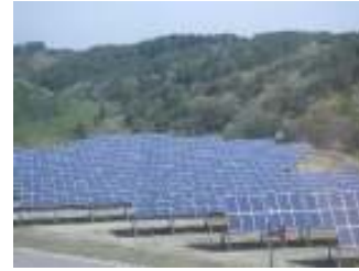
太陽光パネル
